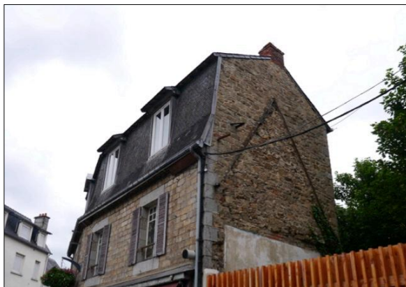
Fig. 267 : Rue des Ponts Saint-Michel, démolition récente d'une maison ou d'un petit immeuble.
