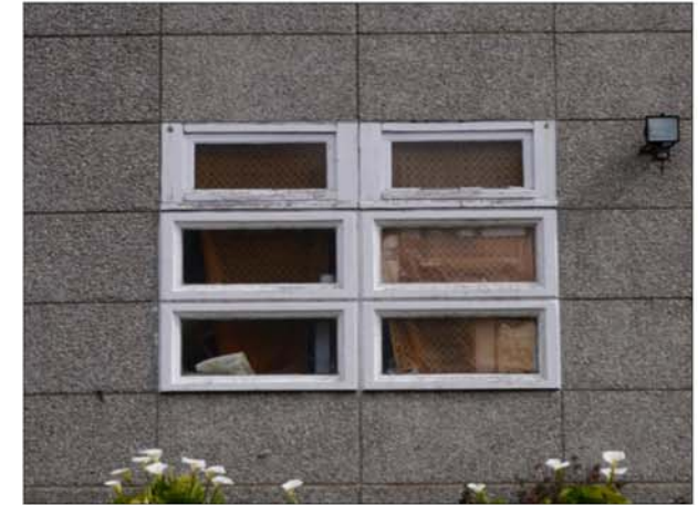
Fig. 69 : Détail du dessin des menuiseries en place d'une maison de la cité des Castors. Années 1950.
