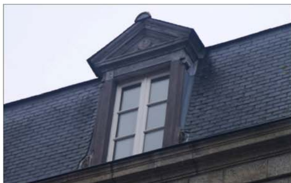
Fig. 333 : lucarne à structure bois, corniche bois des rampants, décor de disque et petites volutes, menuiserie à grands carreaux.
