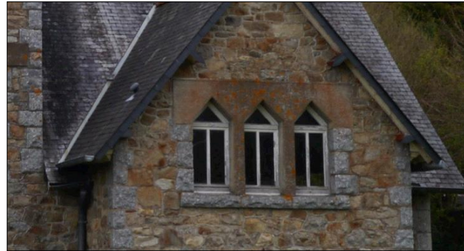
Fig. 312 : série de 3 baies rappelant un triforium. Baies à arc droit brisé, appui encadrement granit gris à bossage rustique, linteau en béton. Sainte-Croix.
